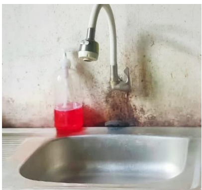
Gambar 3. Foto dinding area cuci tangan sebelum perbaikan
