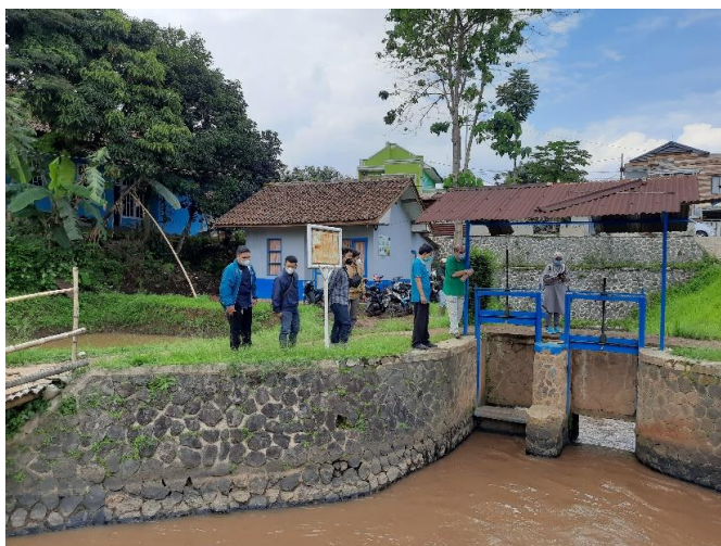
Gambar 2. Pintu air irigasi di kampung Butul desa Cipeujeuh
