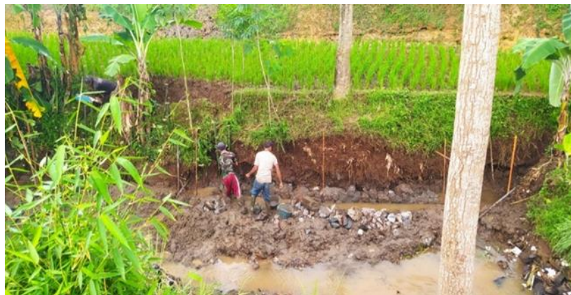
Gambar 4. Pinggiran saluran keluaran air turbin yang berpotensi terkikis air
